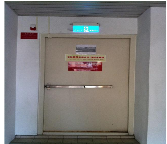
頂樓安全門門位警報系統
